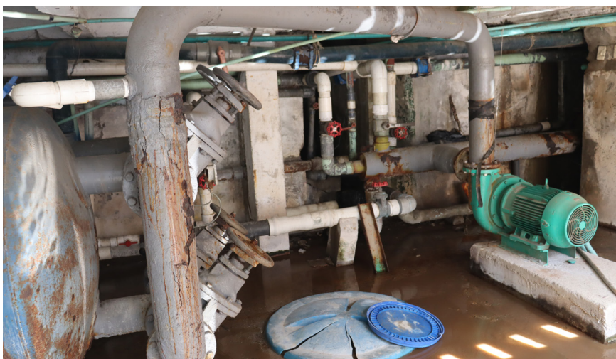
El cuarto de máquinas de la Villa Olímpica totalmente deteriorado.
